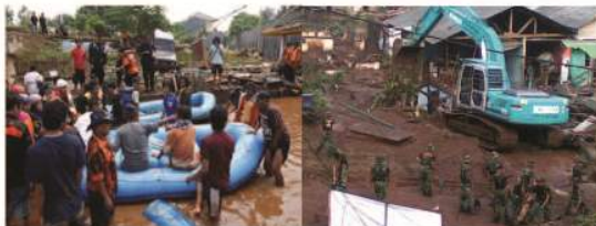
Upaya evakuasi korban dan pembersihan puing akibat jatuhnya tanggul situ gantung. Sumber : BNPB
