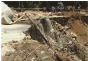
Kerusakan pada behu jalan di Kelurahan Bawang akibat tanah longsor. Sumber : BNPR
