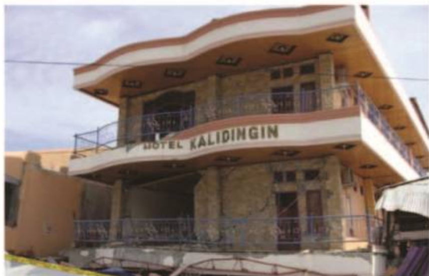
kerusakan akibat gempa di kabupaten manokwari Sumber : BNPB
