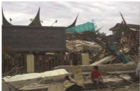
Kerusakan kantor badan perpustakaan dan kearsipan Provinsi Sumatera Barat
