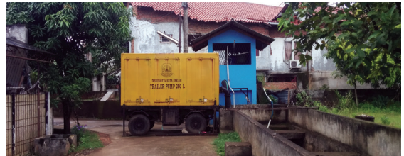
Gambar 9. Foto Pompa Air yang Bisa di Pindahkan Sesuai Lokasi Banjir. Sumber Foto: Peneliti, 2017.
