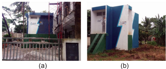
Gambar 7. Gardu PLN di perumahan PGP Jatiasih. Sumber Foto: Peneliti.
